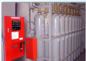
ガス系消火設備
