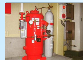
粉末消火設備
